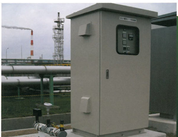
ヒータ制御盤
