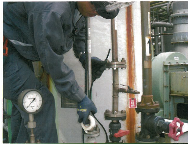
オートトレースヒータ施工例
