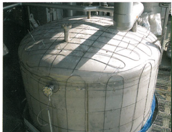
MIヒータ施工例
